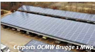
Carports OCMW Brugge 1 MWp
